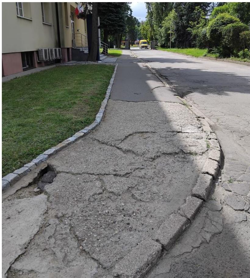
Zdjęcie nr 1 – chodnik wzdłuż drogi dojazdowej do budynku nr 15
