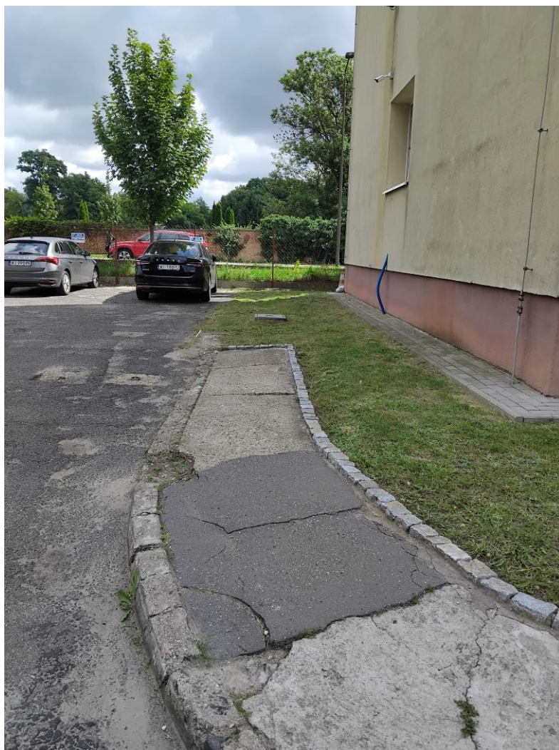
Zdjęcie nr 2 – chodnik wzdłuż parkingu na tyłach budynku nr 15
